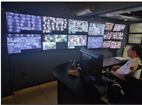
Güvenlik Kontrol Merkezi CCTV izleme ve Güvenlik Otomasyon Sistemleri İşletilmesi
