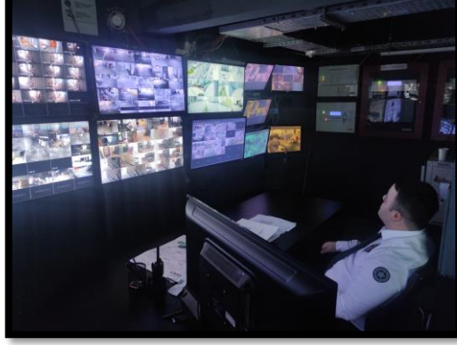
Güvenlik kontrol merkezi 7/24 izlemeleri
