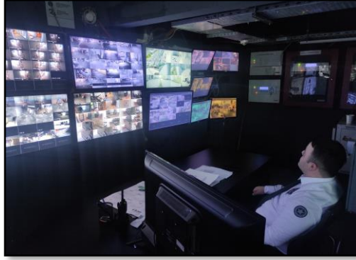
Güvenlik kontrol merkezi 7/24 izlemeleri
